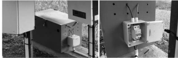
Gambar 8. Saklar Baterai yang terpasang pada Rumah Baterai
