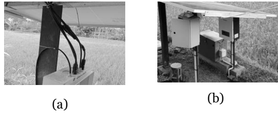
Gambar 7. Keadaan Kabel di Sistem PV Sebelum (a) dan Sesudah(a) Pembaharuan
